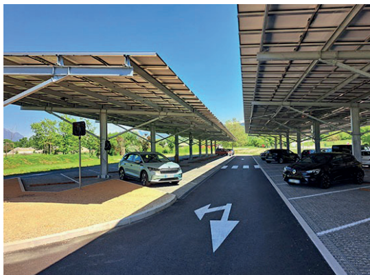
Exemple d'ombrières photovoltaïques.
